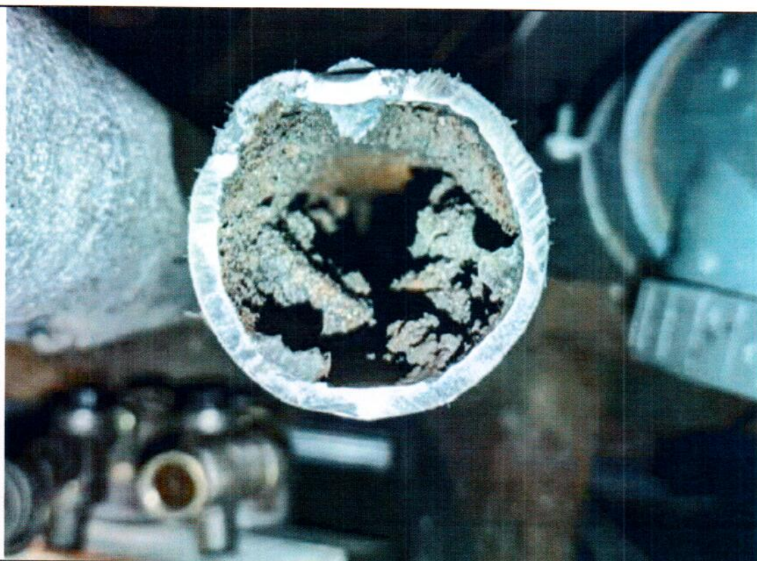
Фото № 40 Вид на срез трубы. Почти на 80 % закрыт условный проход трубы.
