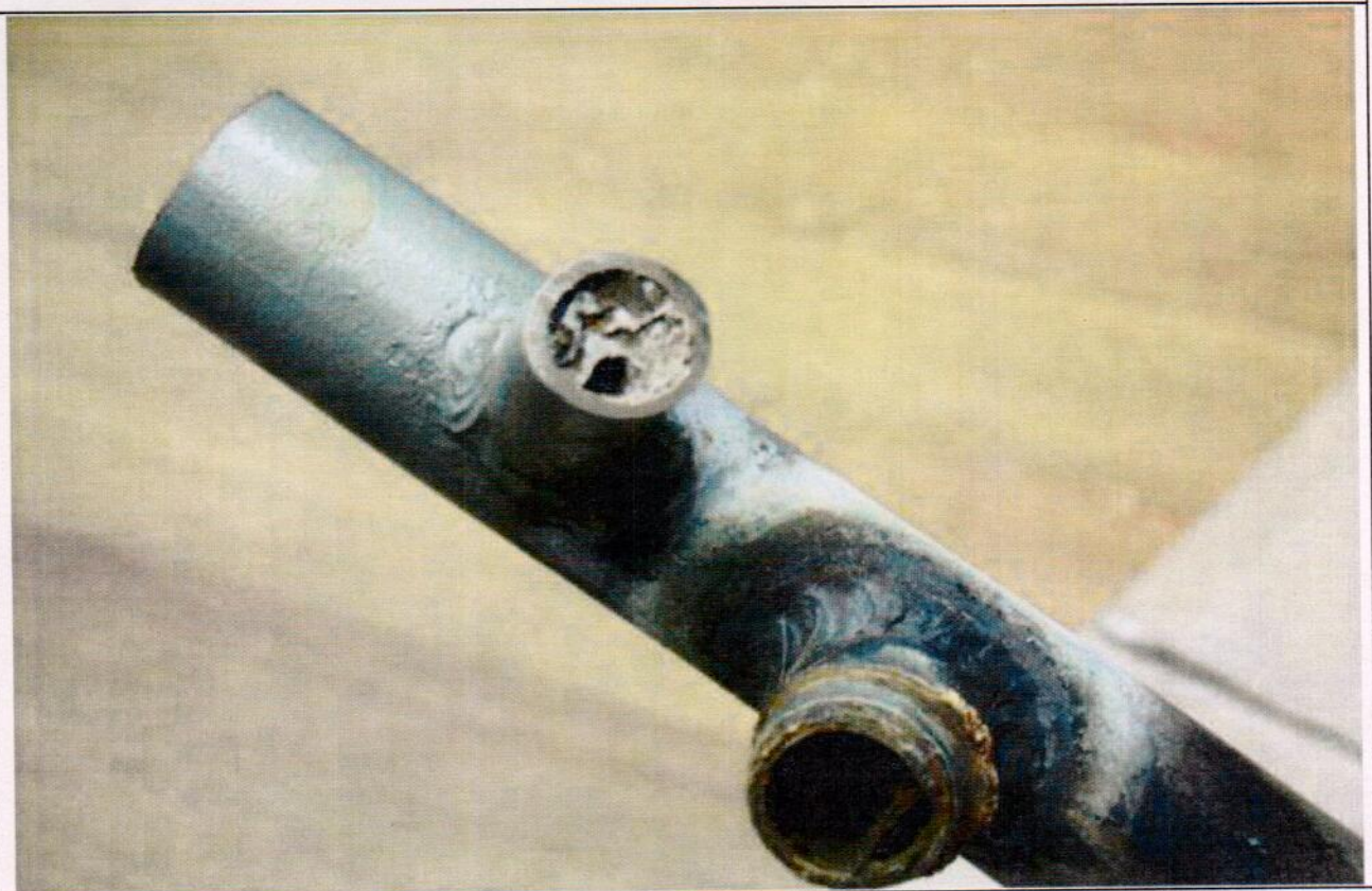
Фото № 9. Вид на закрытый условный проход трубы отвода от стояка ГВС.
