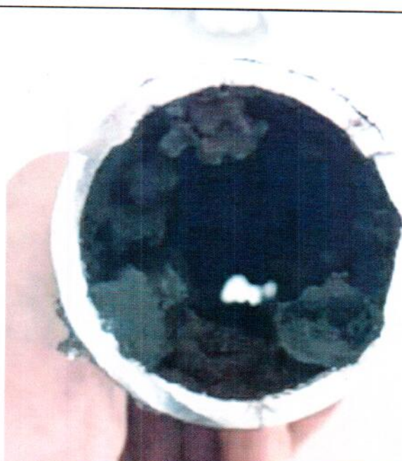
Фото № 47. Вид на срез трубы. Заращение прохода трубы.
