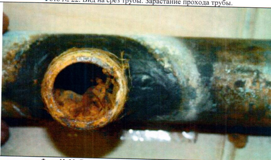
Фото № 23. Вид на срез трубы. Заращение прохода трубы.
