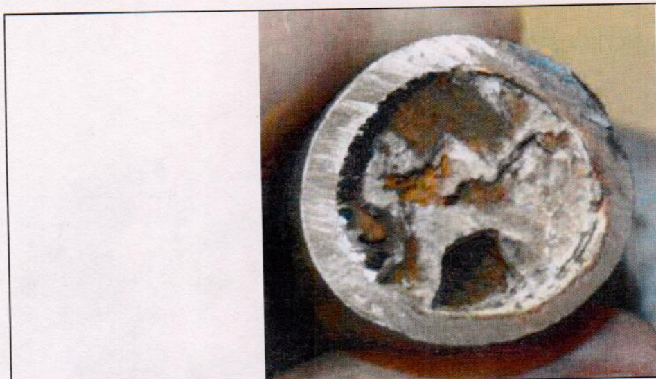
Фото № 29. Вид на срез трубы. Почти на 90 % закрыт условный проход трубы.
