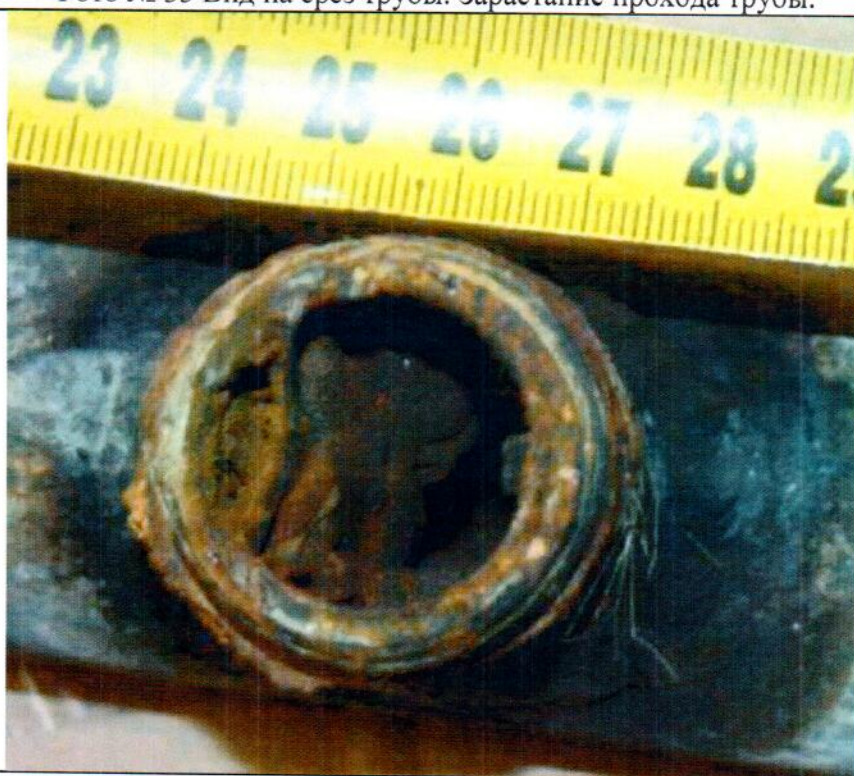
Фото № 36 Вид на срез трубы. Заращение прохода трубы.
