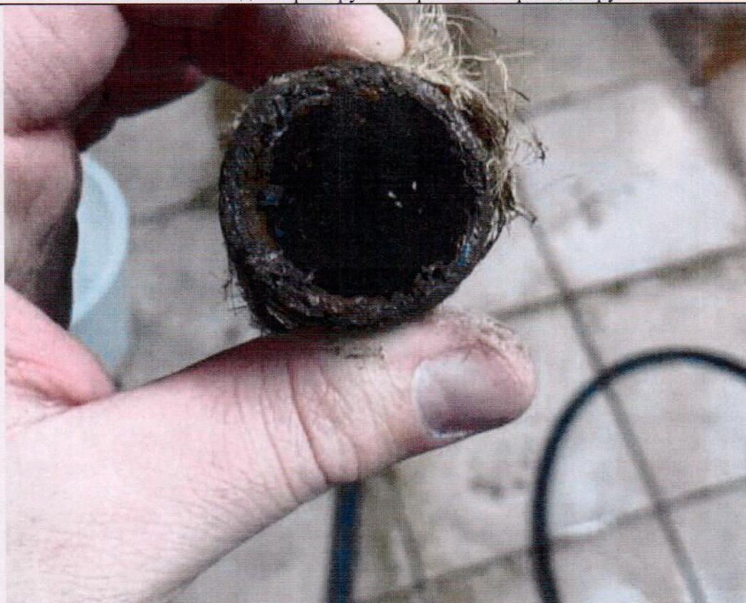
Фото № 43. Вид на срез трубы. Зарастание прохода трубы.
