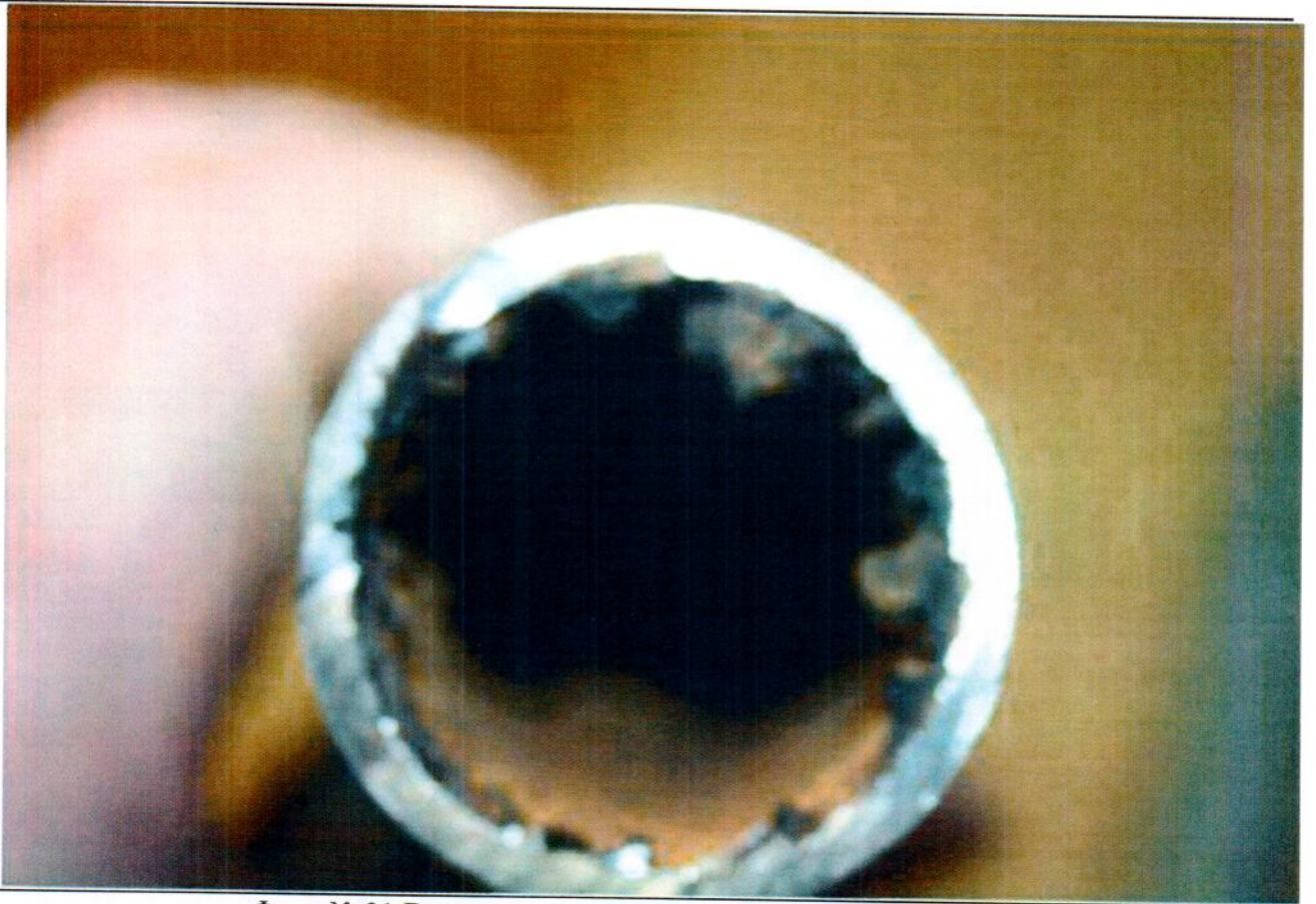
Фото № 31 Вид на срез трубы. Заращение прохода трубы.
