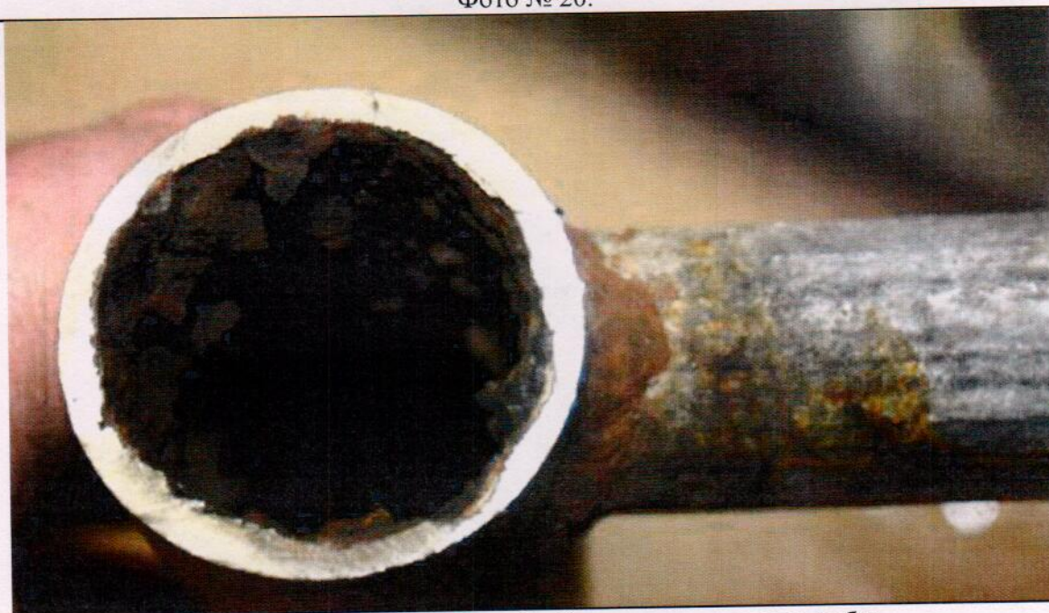
Фото № 21. Вид на срез трубы. Заращение прохода трубы.
