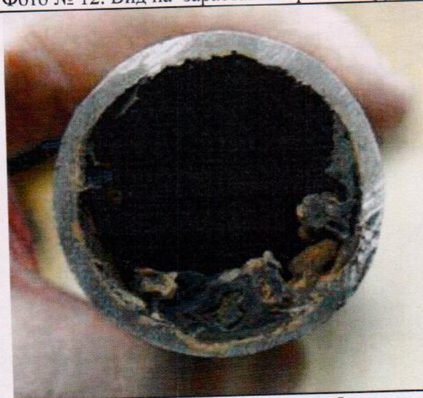
Фото № 13. Вид на срез трубы.
