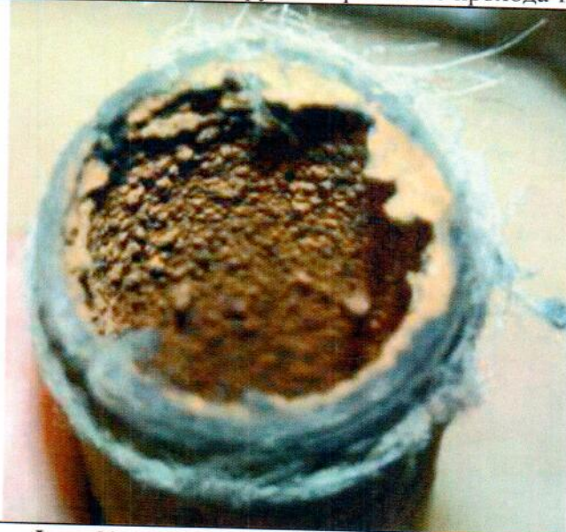
Фото № 19. Шероховатость прохода трубы.
