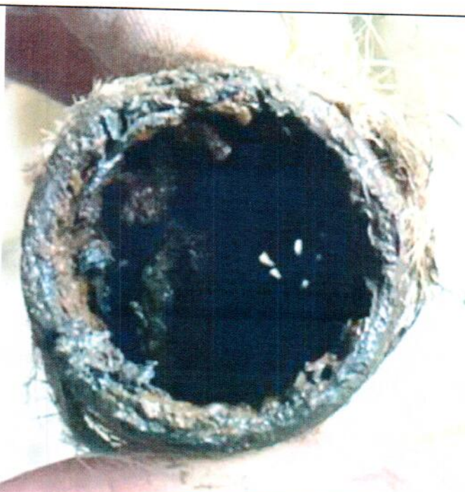
Фото № 44. Вид на срез трубы. Заращение прохода трубы.
