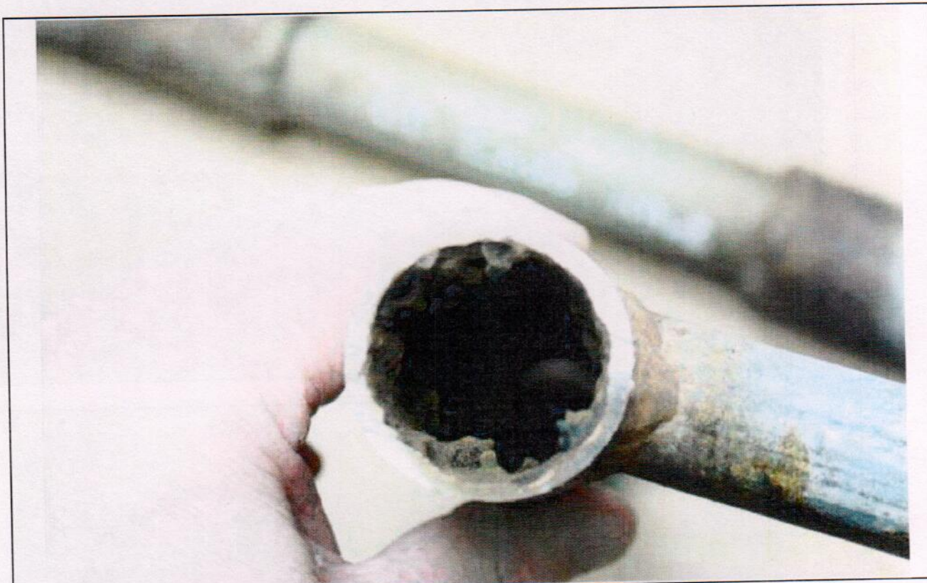
Фото № 16 Вид на срез трубы. Заращение прохода трубы.
