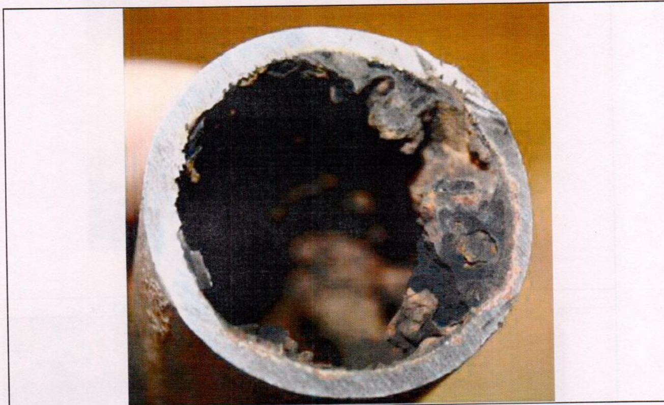
Фото № 25. Вид на срез трубы. Заращение прохода трубы.
