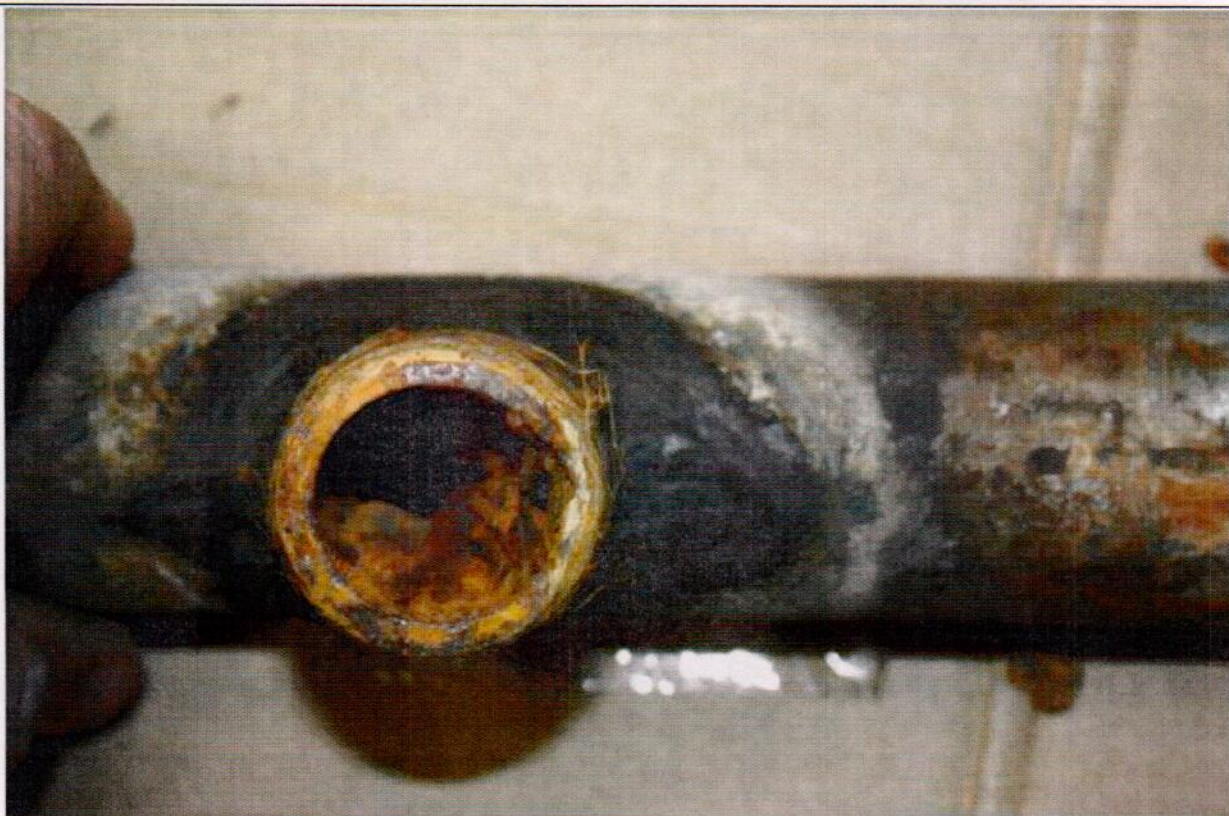
Фото № 42. Вид на срез трубы. Зарастание прохода трубы.
