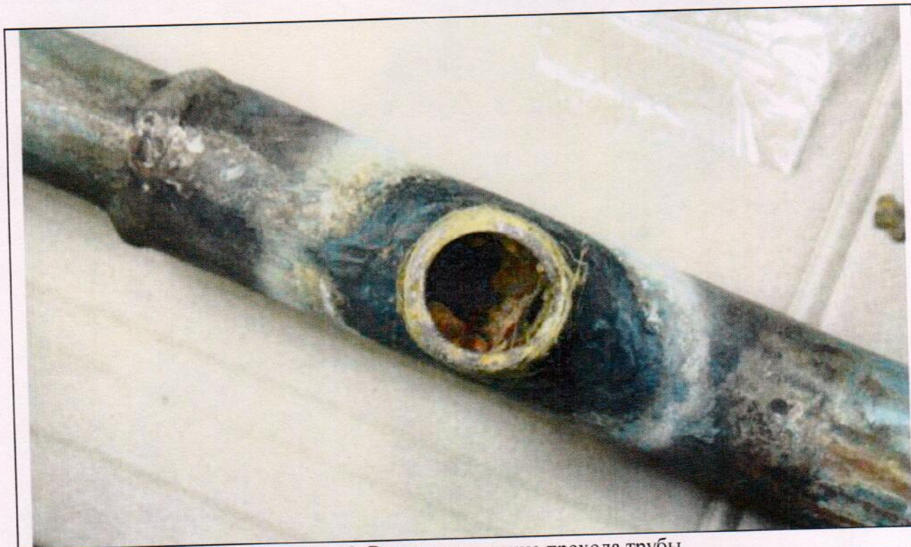
Фото № 12. Вид на зарастание прохода трубы.
