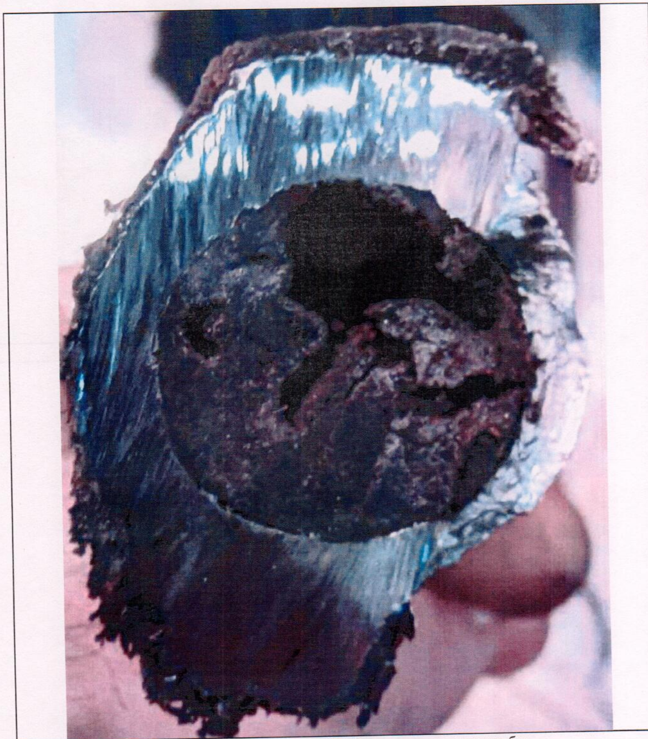
Фото № 46. Вид на срез трубы. Заращение прохода трубы.
