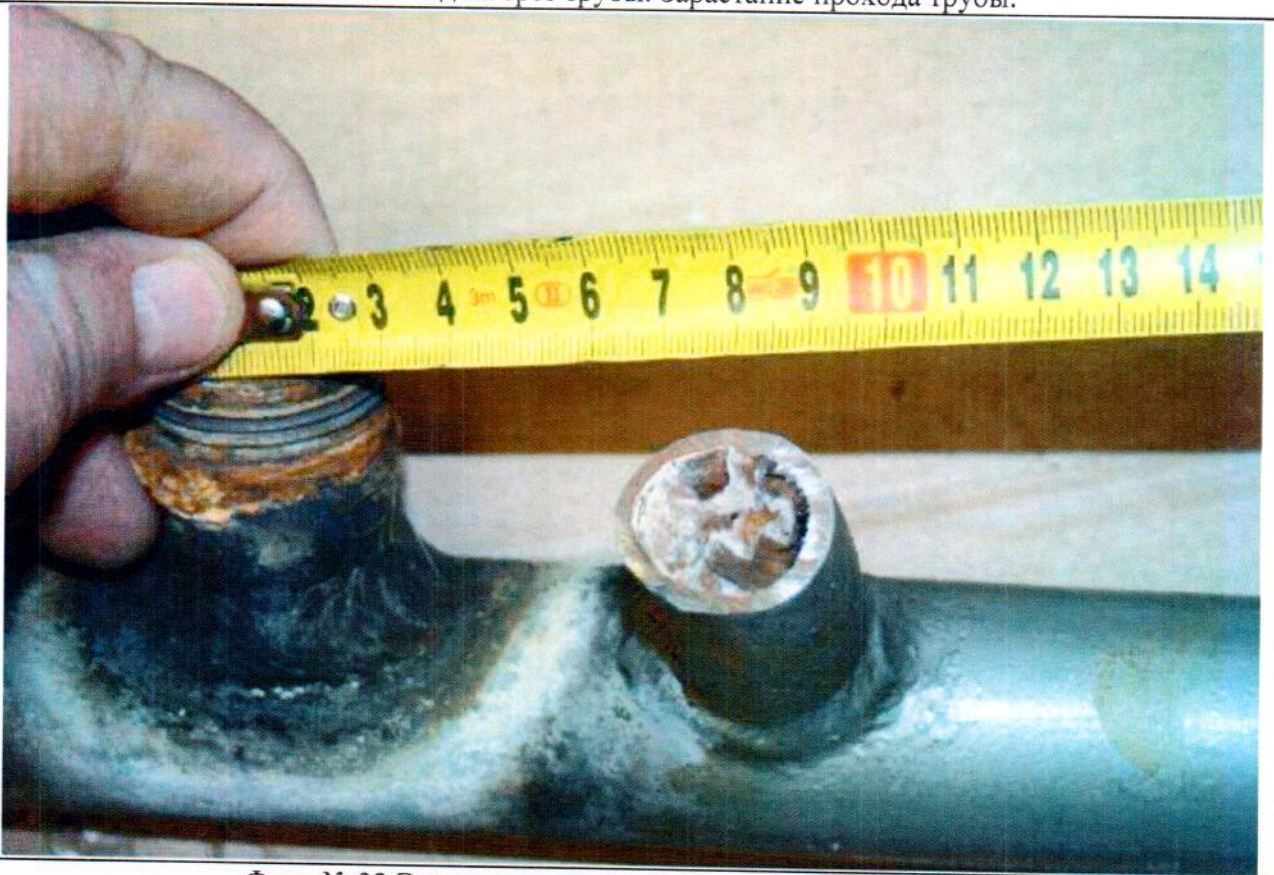
Фото № 32 Вид на срез трубы. Заращение прохода трубы.
