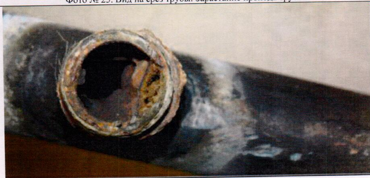
Фото № 26. Вид на срез трубы. Заращение прохода трубы.
