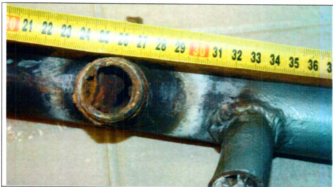
Фото № 35 Вид на срез трубы. Заращение прохода трубы.
