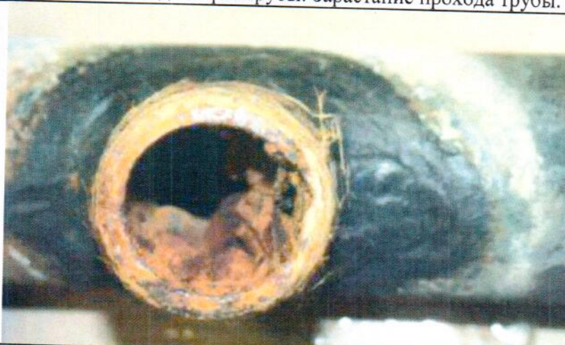
Фото № 24. Вид на срез трубы. Заращение прохода трубы.
